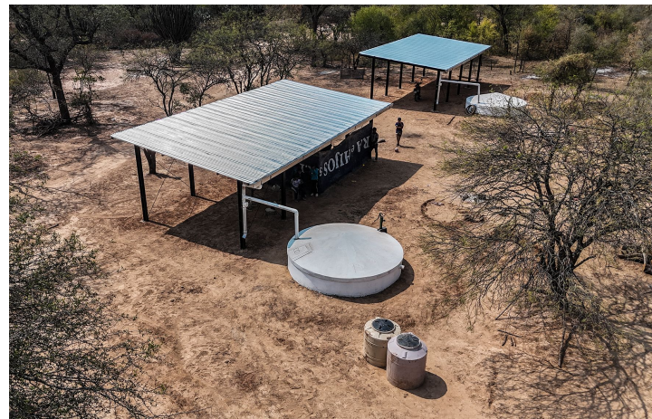
Los sistemas de recolección de agua de lluvia poseen una capacidad de 16.000lts.
